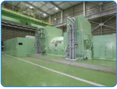
蒸気タービン発電機
