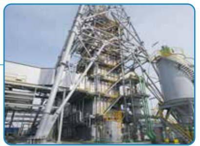
排煙脱硫装置
