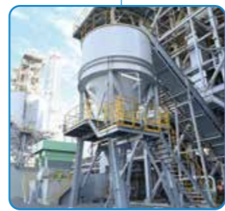
ボトムアッシュ貯槽
