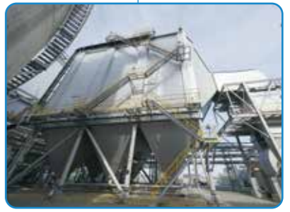
電気集じん装置
