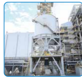
フライアッシュ貯槽
